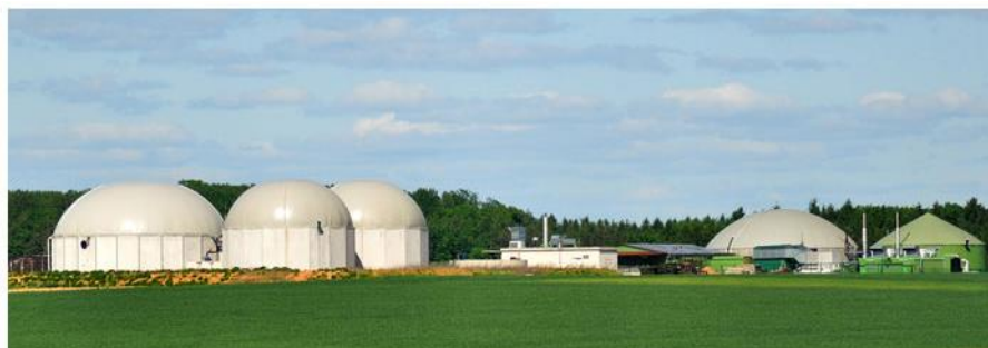
Figure 1-3 : Unité de méthanisation rurale avec stockage du biogaz ( www.agrogas.eu )
