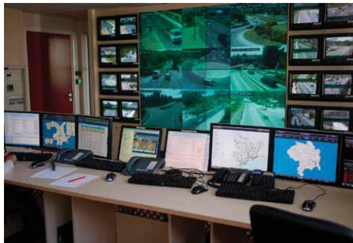
Figure 4 Centre de contrôle et de gestion du trafic du réseau routier du département (Nice)
