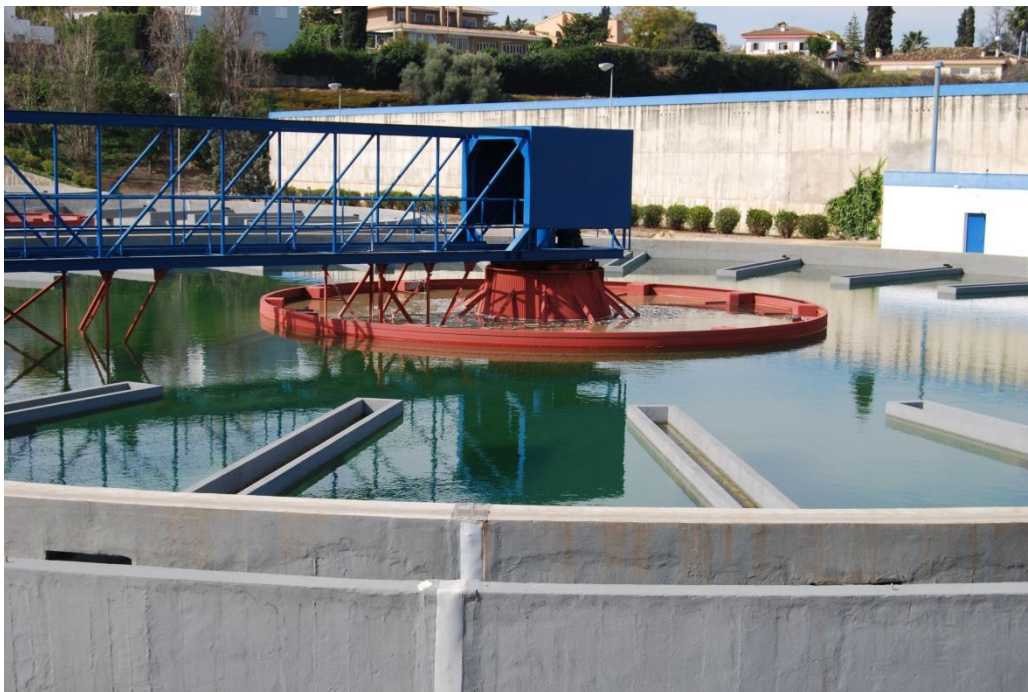
Photo 15 : L'une des deux lignes de décantation en marche au Carambolo
