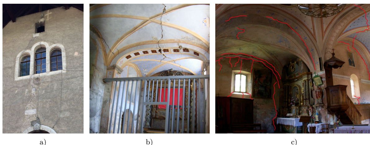
Fig. II.22 Fissures les plus fréquentes. a) verticale dans la façade d'entrée passant par les ouvertures : Saint-Hippolyte, Saint-Paul sur Isère. b) longitudinale au milieu des voûtes et des arcs doubleaux : Sainte-Trinité, la Bourgeat, Bourg-Saint-Maurice. c) jonction entre les voûtes et les murs, en biais dans les voûtes : Saint Germain, Grand Naves, La Léchère
