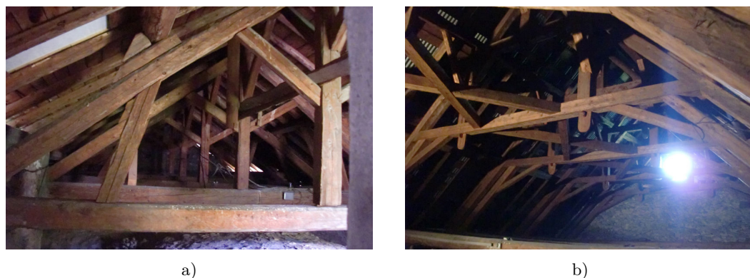
Fig. II.17 Charpentes à structure triangulée. a) Saint-Germain, Grand Nâves, La Léchère : ferme complète. b) Saint-Loup, Servoz : entrails retroussés et deux étages de poinçons.
