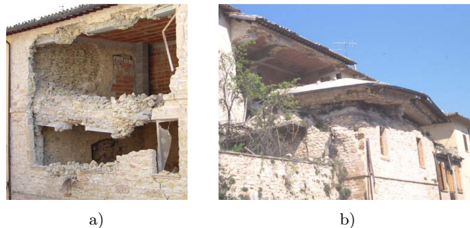
Fig. I.29 Renforcements inadaptés (Binda et al. , 2000b). a) Effondrement hors plan d'un mur porteur : différences de raideurs entre les murs, le plancher et la façade. b) Mauvaise connexion entre la panne* sablière et le mur, coups de butoir du toit.
