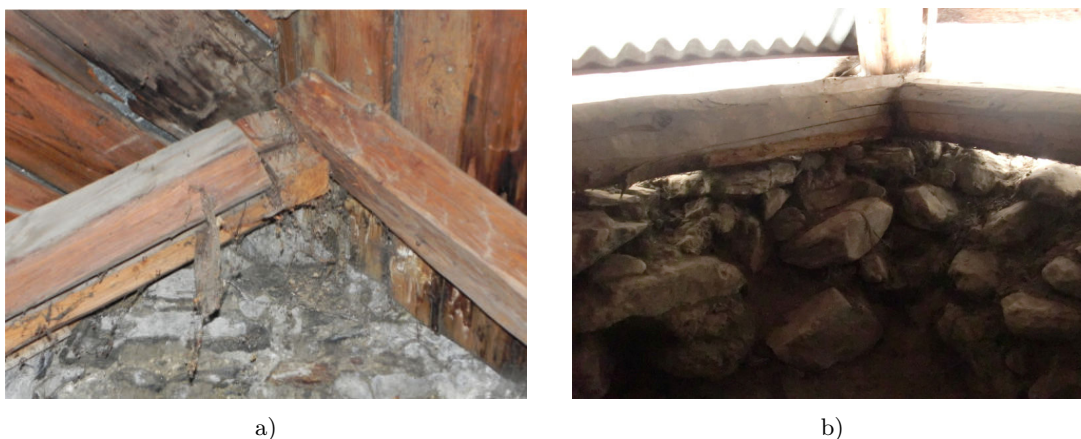
Fig. III.38 Détérioration des liaisons bois-bois et bois-maçonnerie. a) Assemblage dans la charpente de Saint Gervais Saint Prottais, Saint Gervais-les-bains. b) Jour entre le chevet maçonné et la panne sablière, Saint Loup, Servoz.
