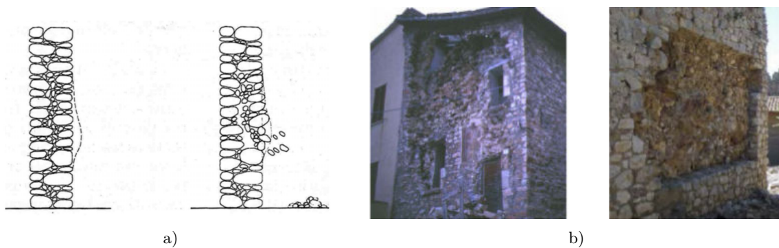
Fig. I.28 Endommagement de murs multi-couches : effeuillage et expulsion de matériaux. a) Mécanisme (Binda et al. , 2006). b) Exemples de dommages (Modena et al. , 2011).
