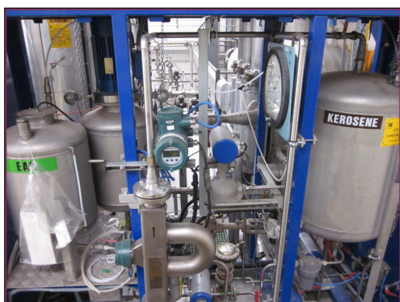
FIGURE 3.2 – Le skid givrage. Il comporte trois cuves, des pompes de transfert et divers capteurs dont un débitmètre.
