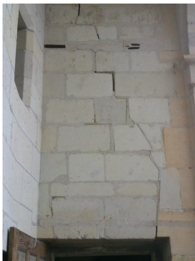
Figure 3.1. Propagation de fissure dans la maçonnerie du château de Chambord
