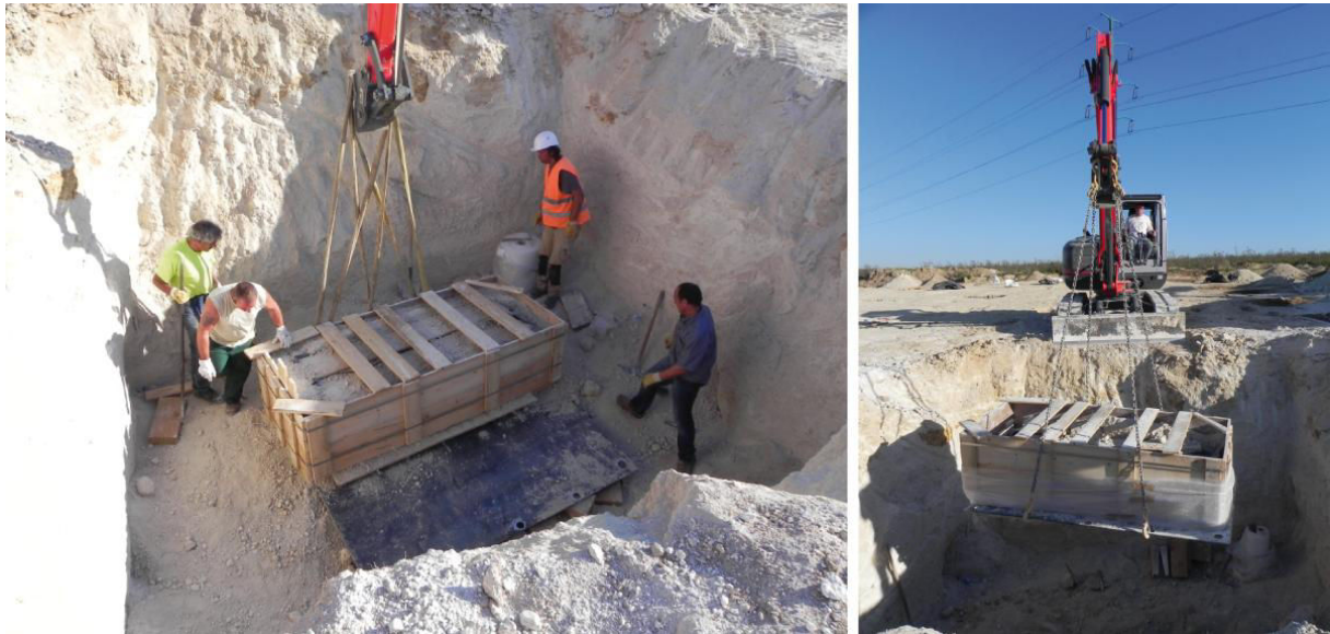
Figure 112 – Bezannes : extraction du cercueil en plomb dans un caisson de bois à la pelle mécanique (clichés : SARM).
