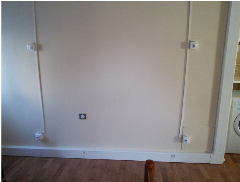
(c) Capteurs PIR installés au niveau de la chambre
