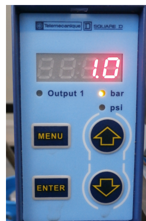
FIGURE D.14 – Boîtier de contrôle du capteur de pression.
