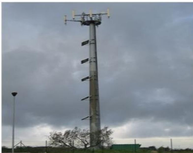
Figure 1.12 : Antenne de transmission de réseau mobile avec des panneaux photovoltaïques
