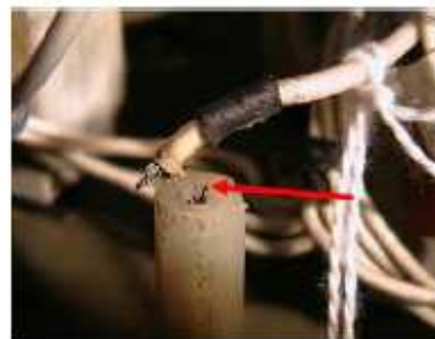
Rupture d'un conducteur
