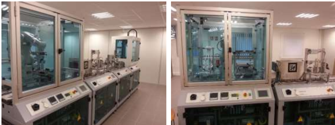
Figure IV.1 : Chaîne de fabrication 4.0 installée au CESI
