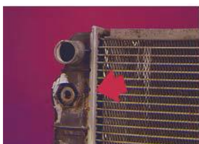
(a) Corrosion des aciers
