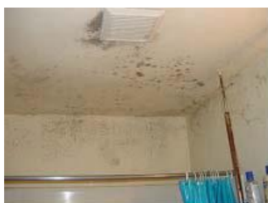
(c) Apparition de moisissures
