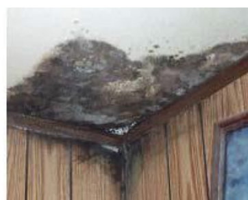
(b) Détérioration du plafond
