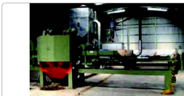
Figura 164. Interior de una planta briquetadora.
