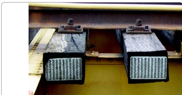
Figura 44. Durmientes de madera instalados en líneas férreas.
