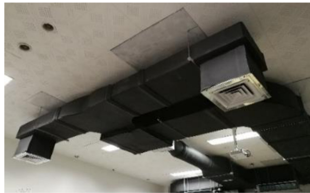
(d) Room terminals
