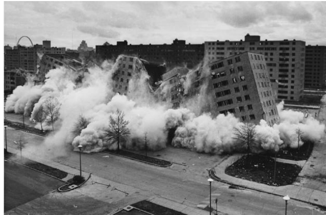
Ilustración 13 - Demolición del Conjunto Racionalista Pruitt-Igou. Construido entre 1954-1955 y demolido en 1972. Fuente: www.archrecord.construction.com . Acceso en 10/2013
