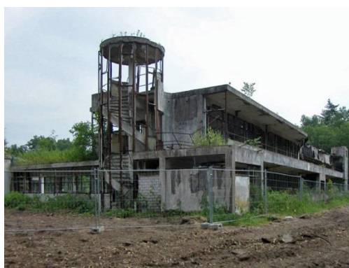
Ilustración 11 – El comprometimiento absoluto de la estructura del Sanatorio Zonnestral en los años de abandono. Fuente: www.wmf.org . Acceso en 10/2014
