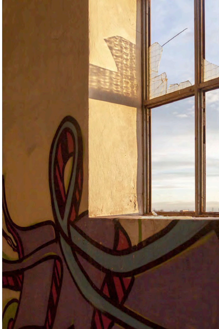
Img 19. El propio estado deteriorado favorece la conexión espacial.
