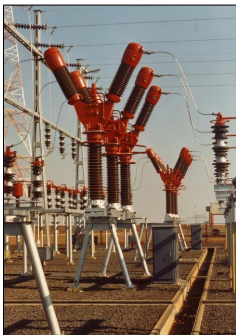
Εικόνα 2.8: Διακόπτες Ισχύος Υψηλής Τάσεως Τύπου Πτωχού Ελαίου. 1
