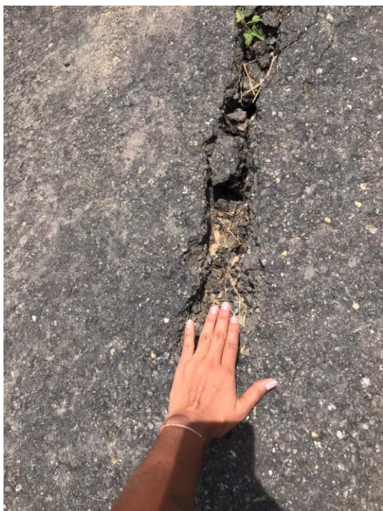
ILUSTRACIÓN 11 AGRIETAMIENTO VÍA BOQUERÓN
