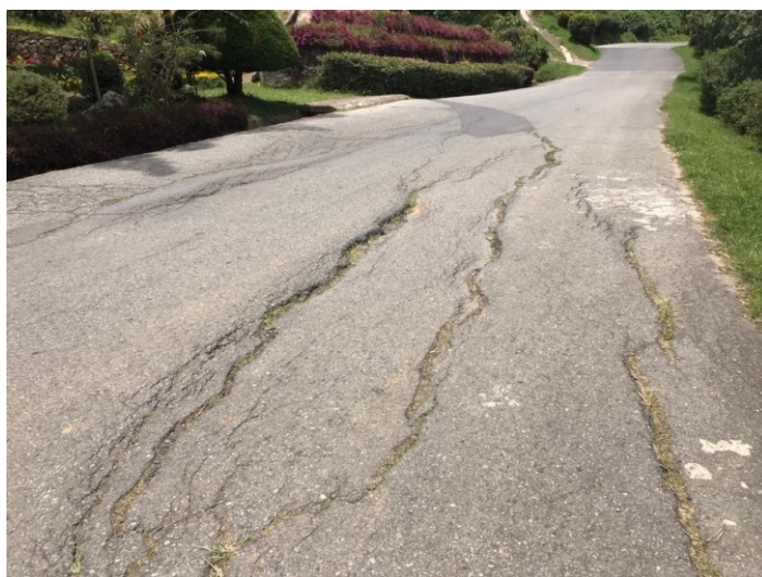
Ilustración 1 hundimiento de vía san José-boquerón
