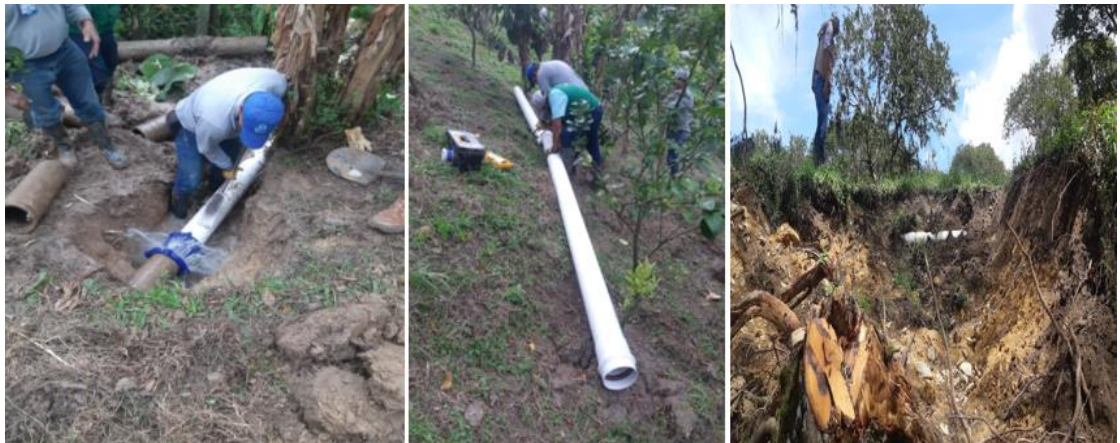
Fotografía 15. Renovación de tubería de A.C. a tubería de PVC, por parte de la empresa prestadora del servicio.
