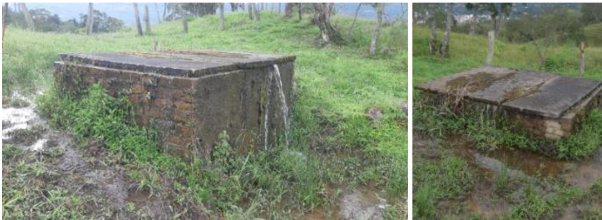
Fotografía 18. Registro fotográfico de la cámara quiebre número 4 con un rebose y desperdicio de agua considerable.
