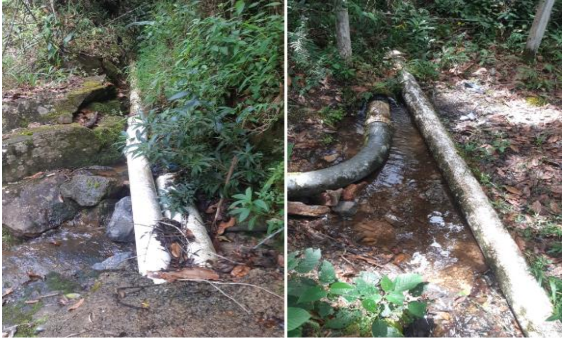
Fotografía 12. Tubería expuesta a la intemperie. Izquierda fotografía de la salida de la captación hacia la planta – Derecha tubería de llegada al tanque desarenador
