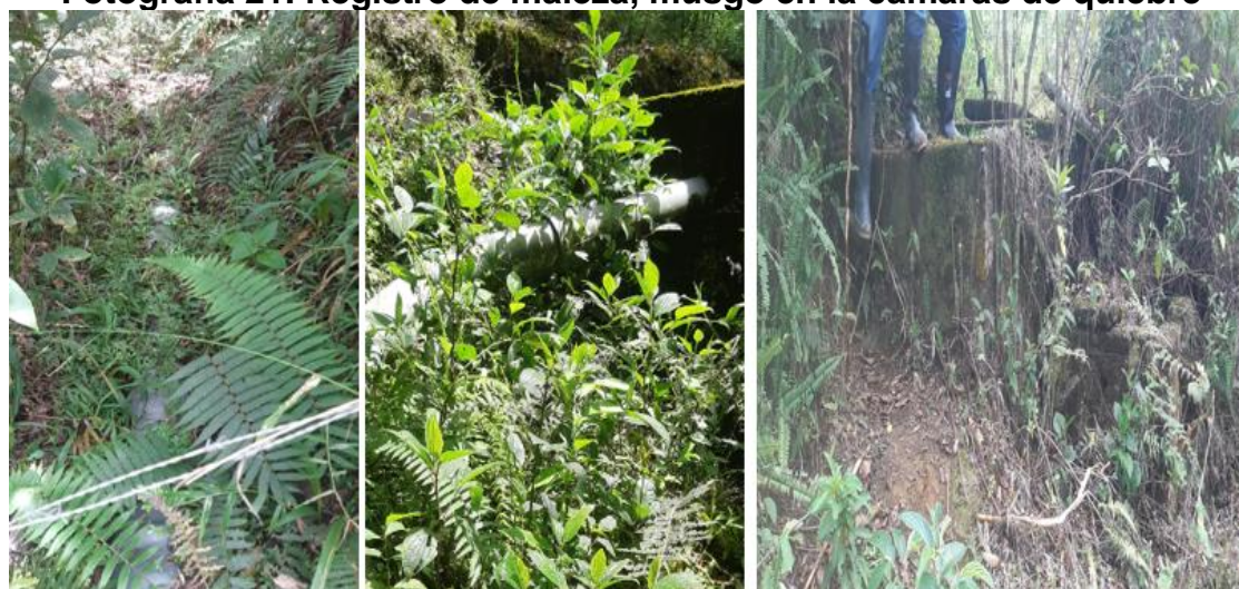
Fotografía 21. Registro de maleza, musgo en la cámaras de quiebre
