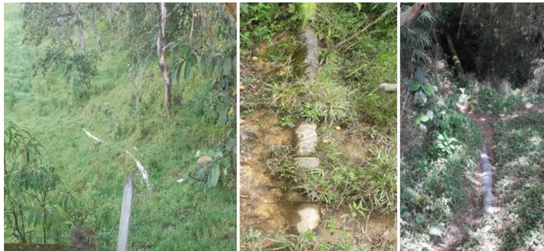
Fotografía 20. Registro de la tubería a la intemperie de la red de conducción
