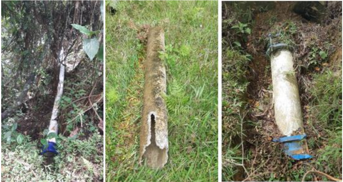
Fotografía 14. Daños y reparaciones en la red de asbestocemento.
