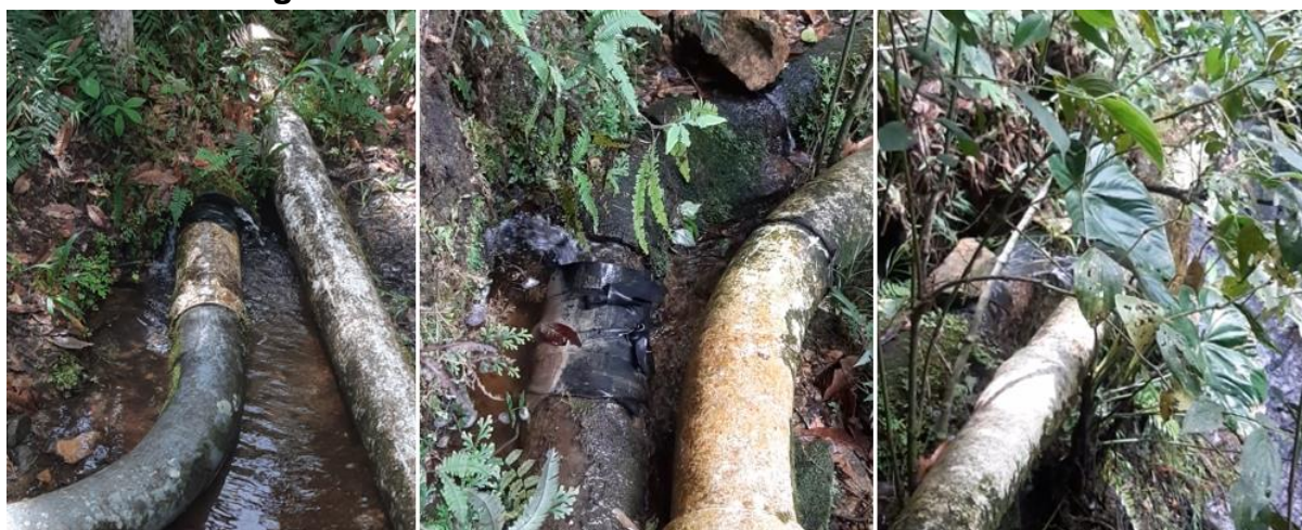
Fotografía 11. Estado de la línea de aducción la línea 1
