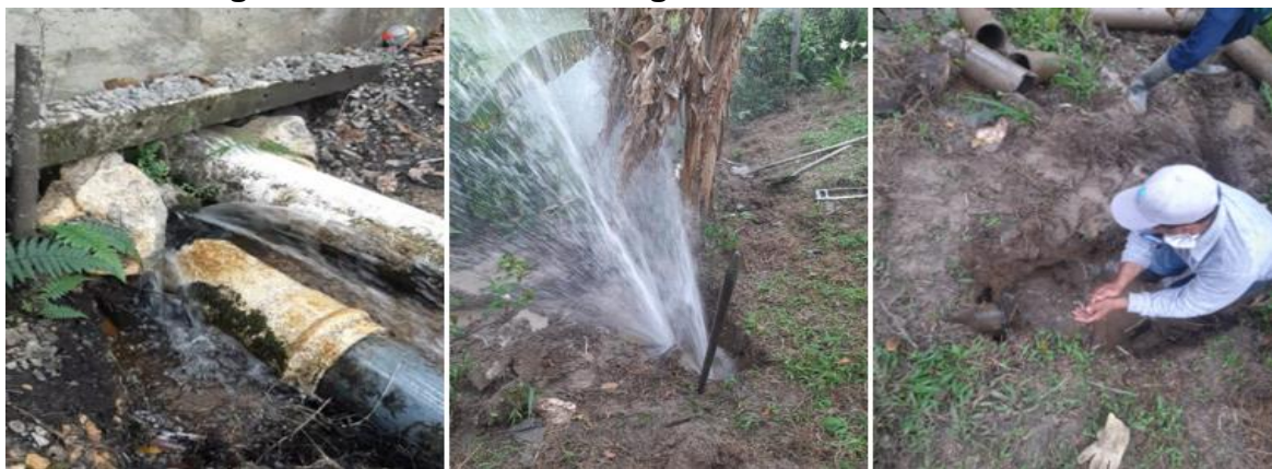
Fotografía 13. Evidencia de fugas en la red de conducción.
