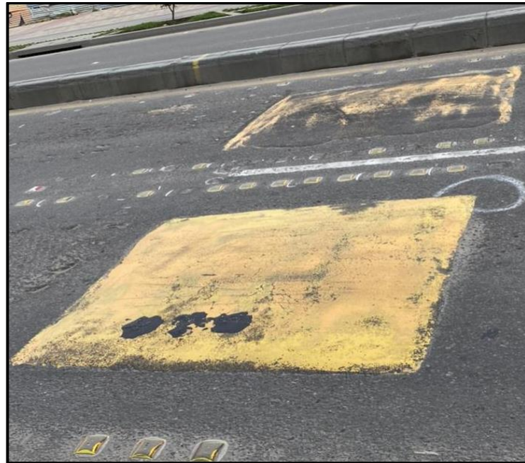
Ilustración 17. Reductor en mal estado.
