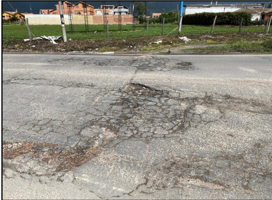
Ilustración 31. Fallo Ingreso Glorieta Variante Cota – Suba.
