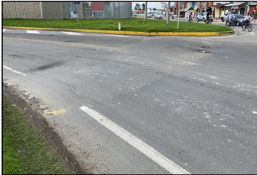
Ilustración 37. Resalto en mal estado - salida Variante Cota.
