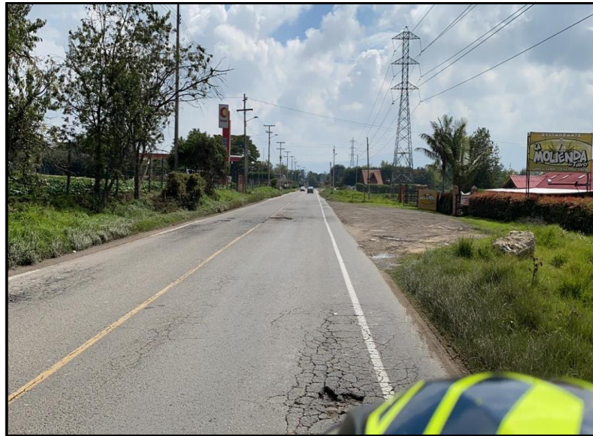
Ilustración 33. Estado general del Tramo 3.
