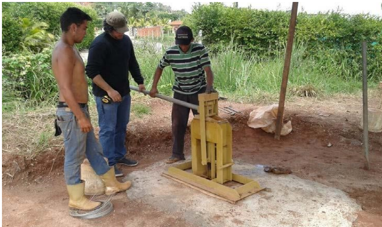
Imagen 30 Cerrado de la cámara compactadora. Fuente: Propia
