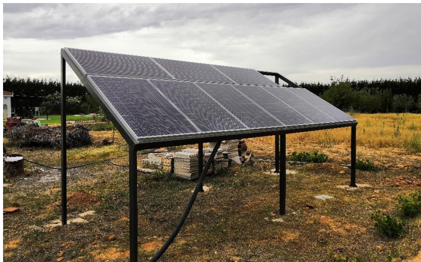
Ilustración 1. 1. Placas solares instaladas
