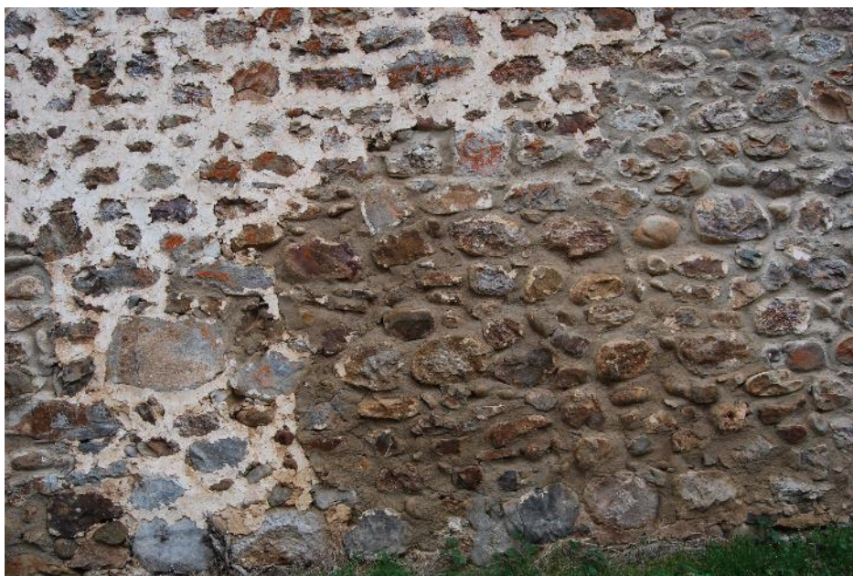
Figura 73. Iglesia de Las Vegas. Humedad en el muro exterior norte. (Fotografía de la autora)
