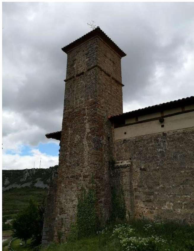
Figura 66. Iglesia de San Antón. Vegetación en la torre y muro norte. (Fotografía de la autora)
