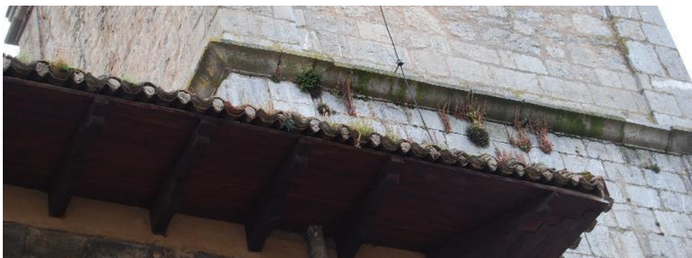
Figura 86. Iglesia de San Martín. Vegetación arraigada en la torre. (Fotografía de la autora)
