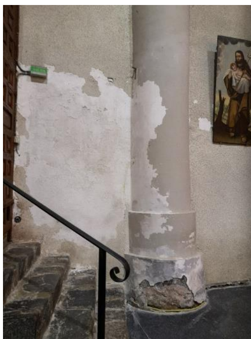
Figura 88. Iglesia de San Martín. Deterioro muro norte interior y pilastra. (Fotografía de la autora)
