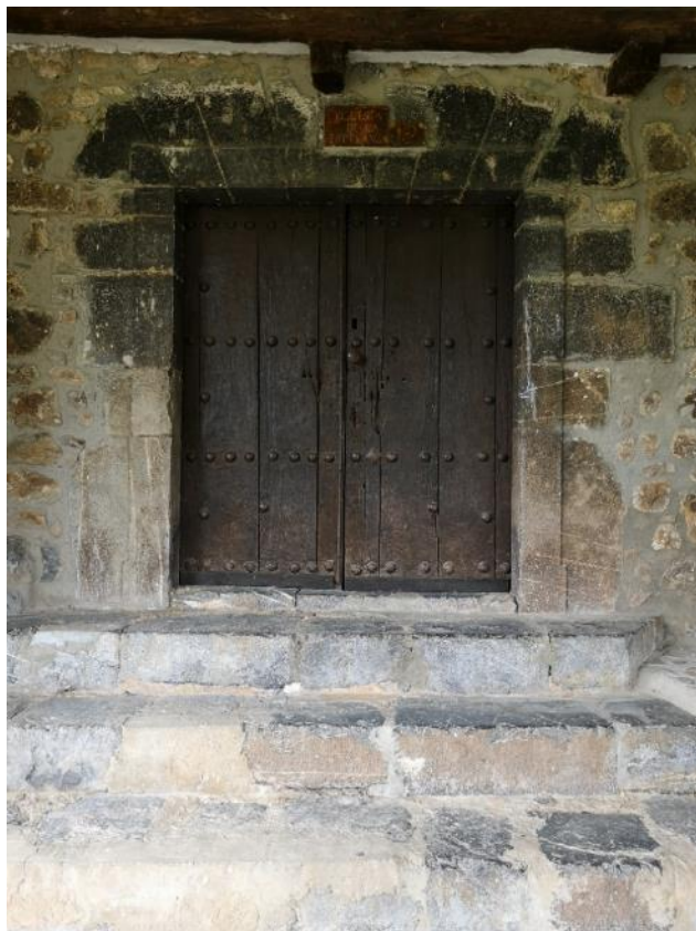
Figura 58. Iglesia de San Antón. Ingreso sur. (Fotografía de la autora)
