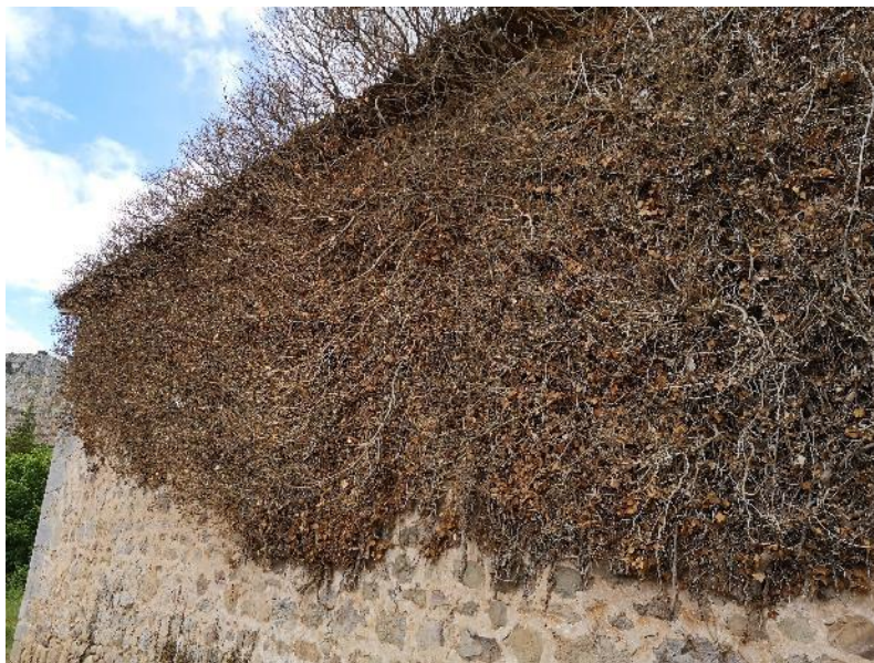
Figura 36. Ermita de San Lázaro. Vegetación arraigada en el muro. (Fotografía de la autora)
