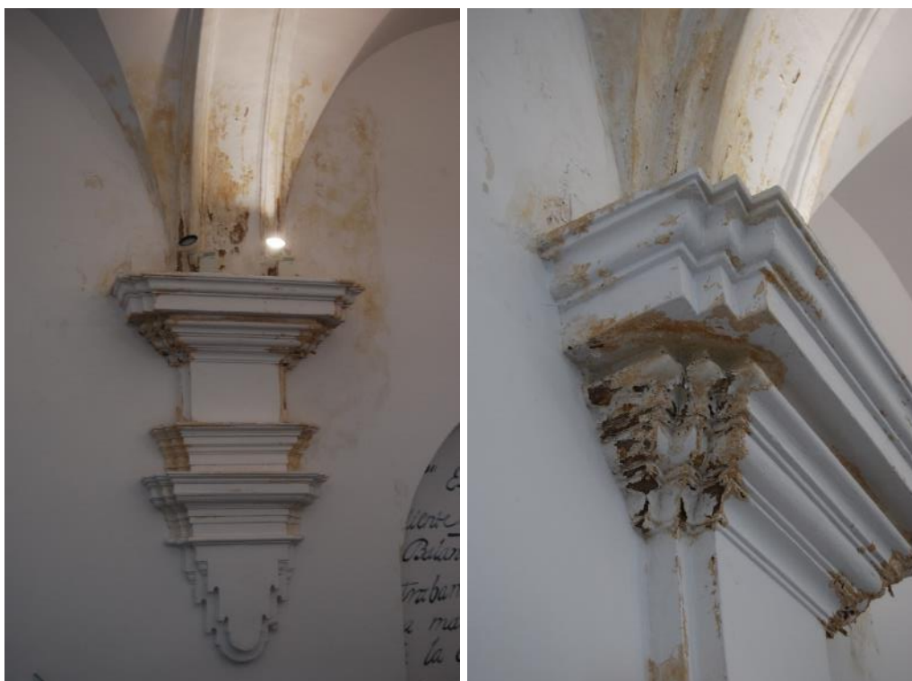
Figura 56. Ex convento de San Francisco. Deterioro de los arranques de los arcos. (Fotografía de la autora)
