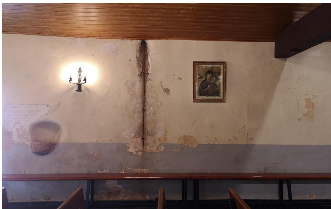
Figura 50. Ermita de Santa Águeda. Deterioro muro sur. (Fotografía de la autora)
