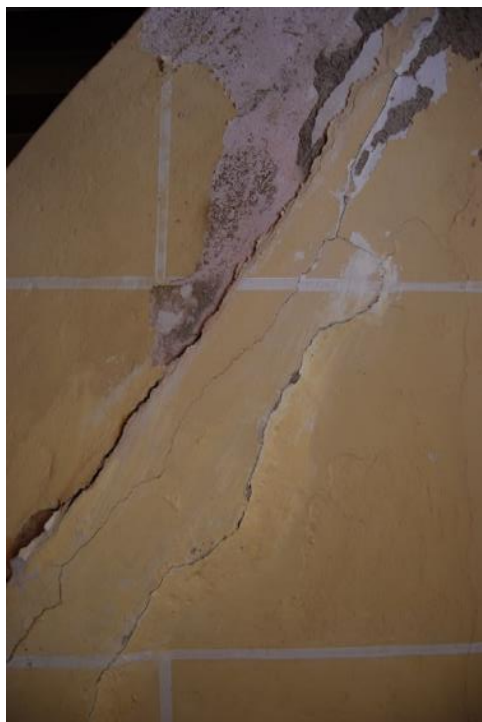
Figura 22. Ermita de Nuestra Señora de Tómalos. Grieta del muro bajo el coro. (Fotografía de la autora)
