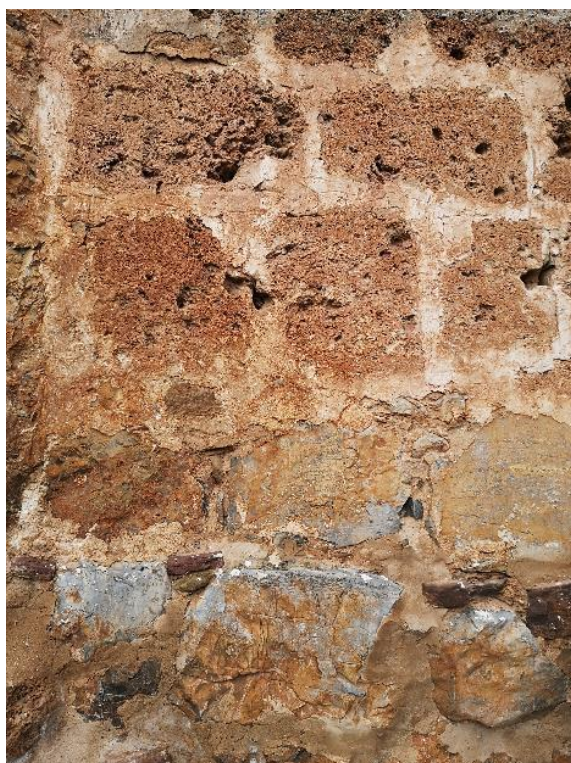
Figura 61. Iglesia de San Antón. Detalle de materiales constructivos. (Fotografía de la autora)
