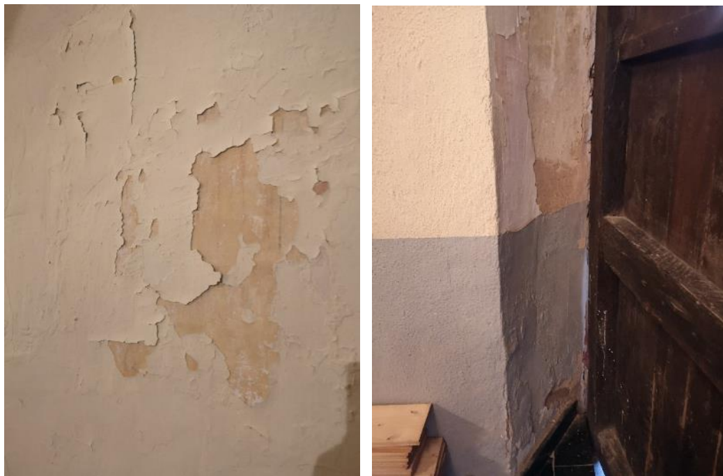
Figura 51. Ermita de Santa Águeda. Deterioro de los muros. (Fotografía de la autora)
