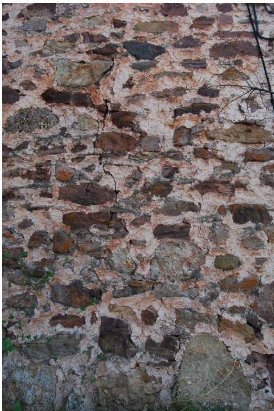
Figura 20. Ermita de Nuestra Señora de Tómalos. Grieta vertical en el muro. (Fotografía de la autora)
