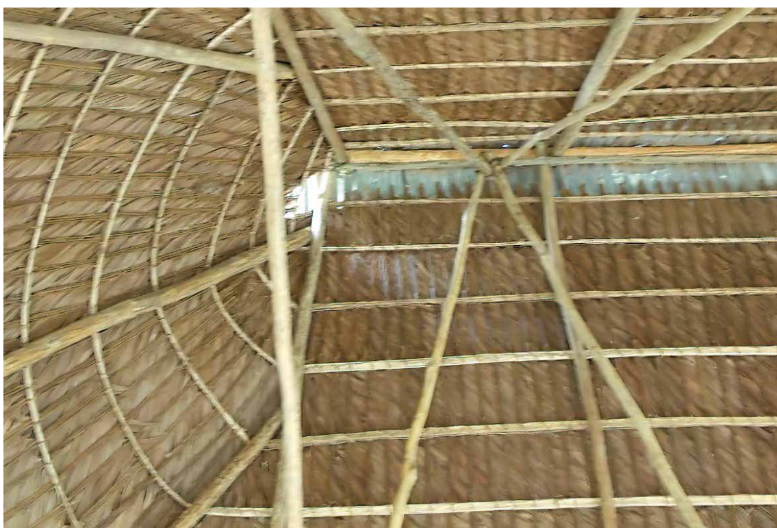
Foto 379 y Foto 380: Construcción mixta no concluida destinada a escuela. Fuente: Autores (2019).
