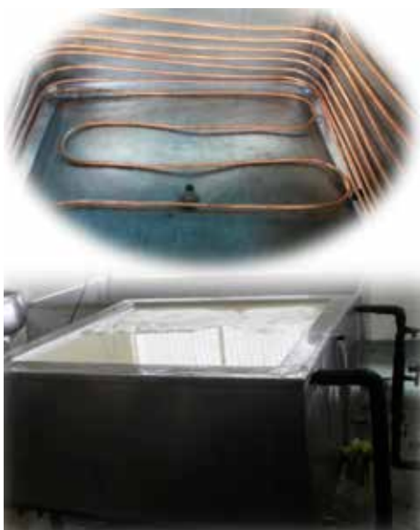
Figura 15. Uso de agua caliente II. Para pasteurización de la leche. Superior: interior de la marmita donde se encuentran tubos de cobre en cuyo interior circula el agua caliente (70°C) para calentar la leche. Inferior: Marmita con 600L de leche en proceso de pasteurización con agua caliente procedente de los colectores solares. (Planta procesadora de productos lácteos LLAFRAK, en Juanilama de Santa Rosa de Pocosol).
