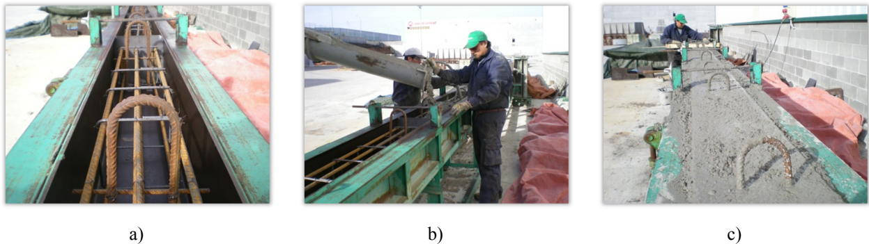
Figura B.2 Procesos ejecución de las vigas V: a) montaje de la armadura, b) vertido del hormigón, c) enrasado y acabados de la cara superior.
