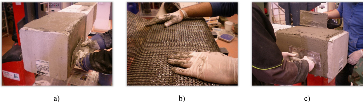
Figura B.6 Aplicación del TRM en las vigas V: a) aplicación de la primera capa de mortero, b) embebición del tejido en la matriz, c) acabados superficiales en la segunda capa de mortero.
