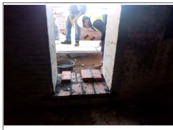
FOTO 6: MASSISSAT DE FORATS FAÇANA
