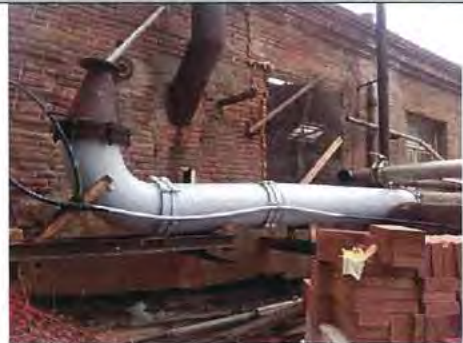
DESCRIPCIÓ: estabilització element amiant
