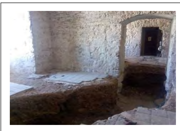
FOTO 5: PAS SALA 32-33 RASA INSTAL·LACIONS
