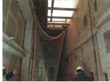
DESCRIPCIÓ: enderrocs forjats escala interior
