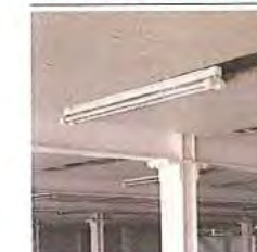
IL·LUMINACIÓ: REGLETA FLUORESCENTS (a recuperar del estat actual)
