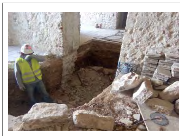
FOTO 6: PAS SALA 32-33 RASA INSTAL·LACIONS
