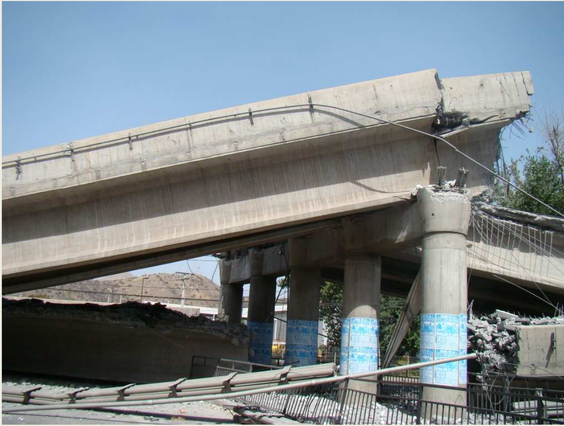
Figura 31: Tablero con vigas con daño severo. Fuente: PREANSA (27/02/2010).
