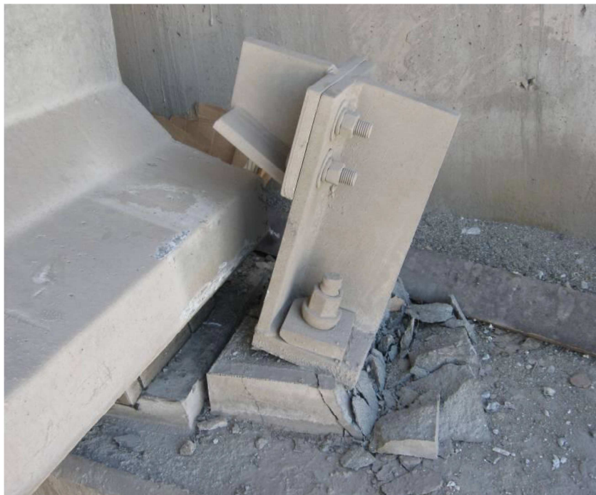
Figura 54: Anclaje vertical en grapa o clip colapsado por la combinación de esfuerzos horizontales y verticales. Fuente: Matías Hube
