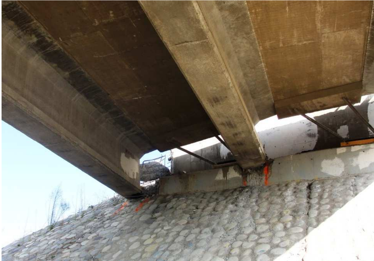
Figura 56: Fallo en las barras debido a la ausencia de topes transversales. Fuente: Propia (08/03/2010)
