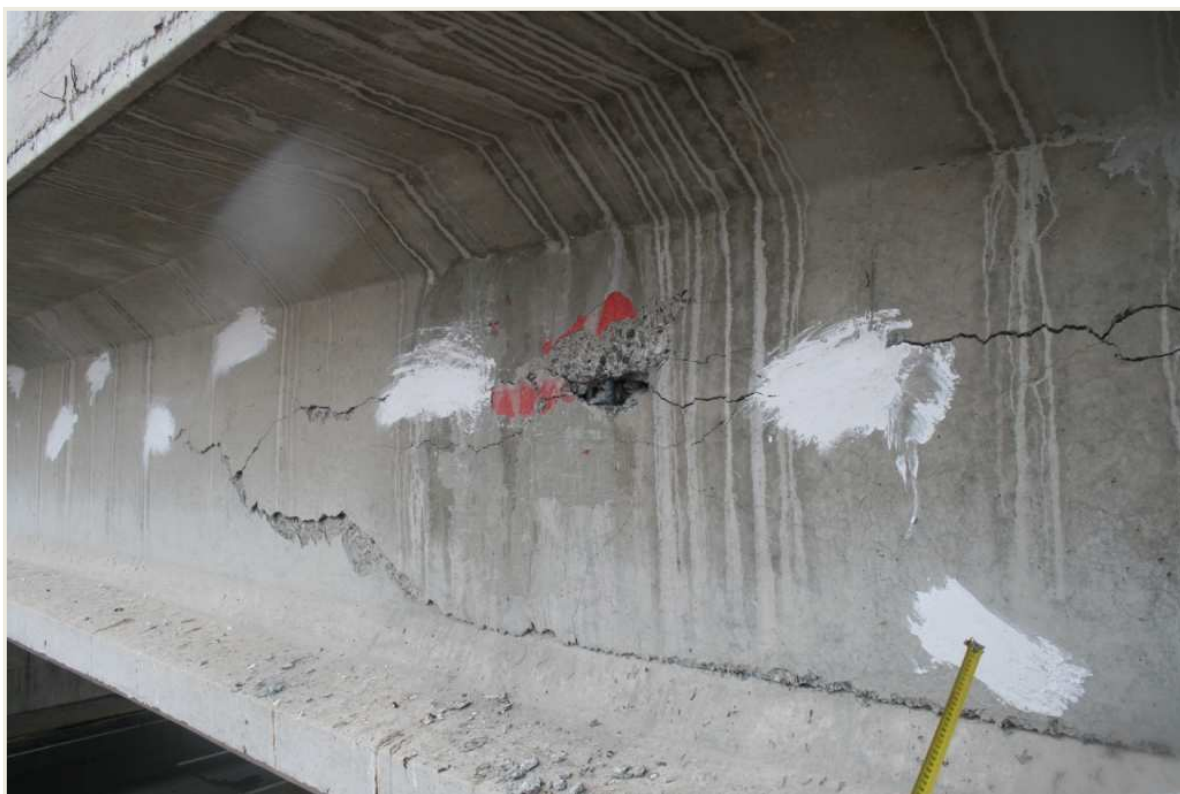
Figura 30: Viga con daños moderados tras el terremoto. Fuente: Propia (16/04/2010).
