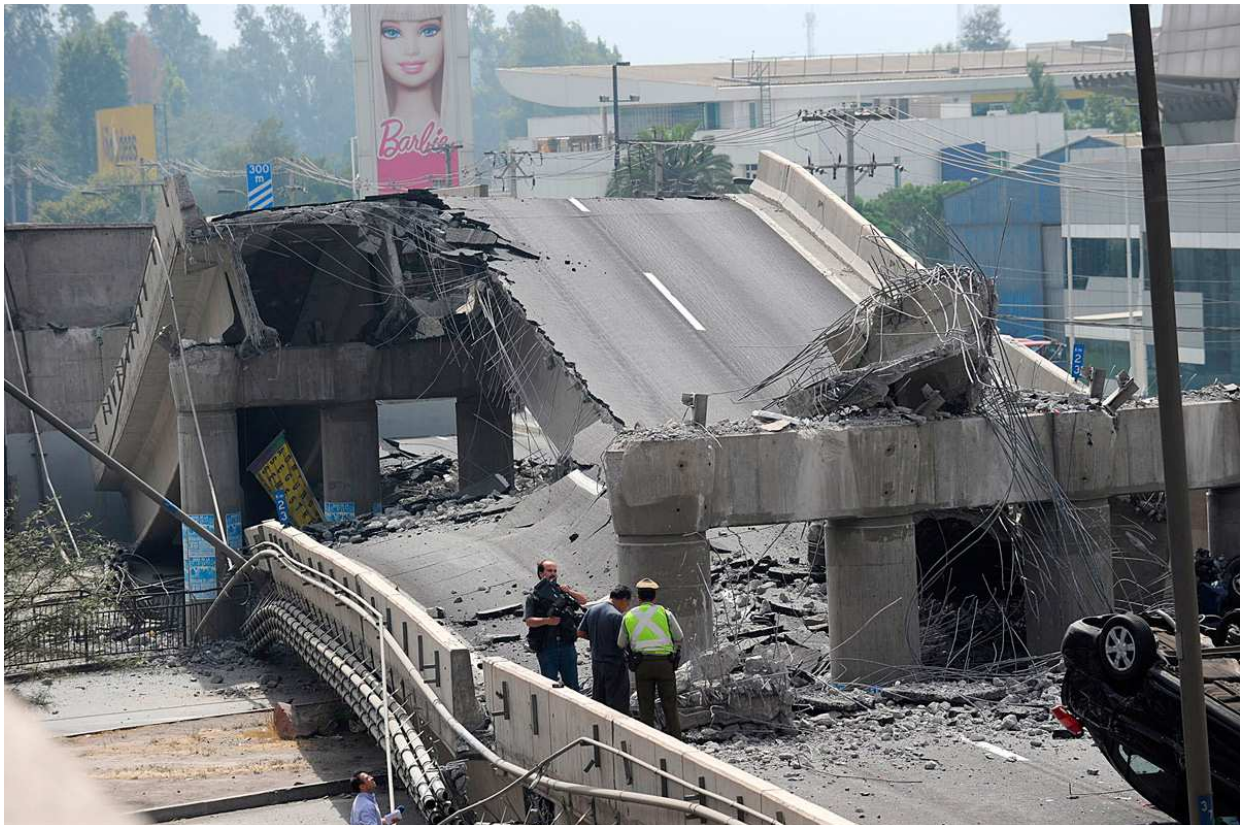
Figura 9. Viaducto colapsado en la circunvalación norte de Santiago de Chile. Fuente: El Mercurio, Chile.
