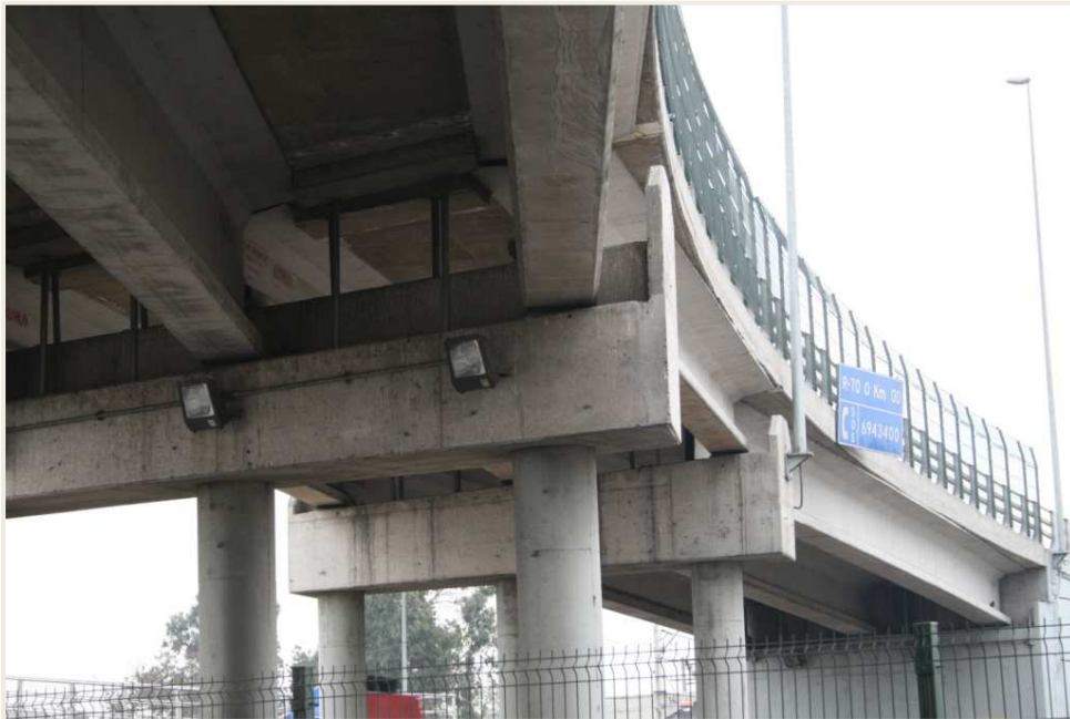
Figura 40: Inexistencia de tope transversal, dintel con aletas. Fuente: Propia (26/04/2010).
