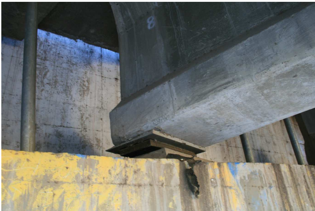
Figura 61: Viga y aparato de apoyo anclado desplazado tras el terremoto. Fuente: Propia (04/04/2010)
