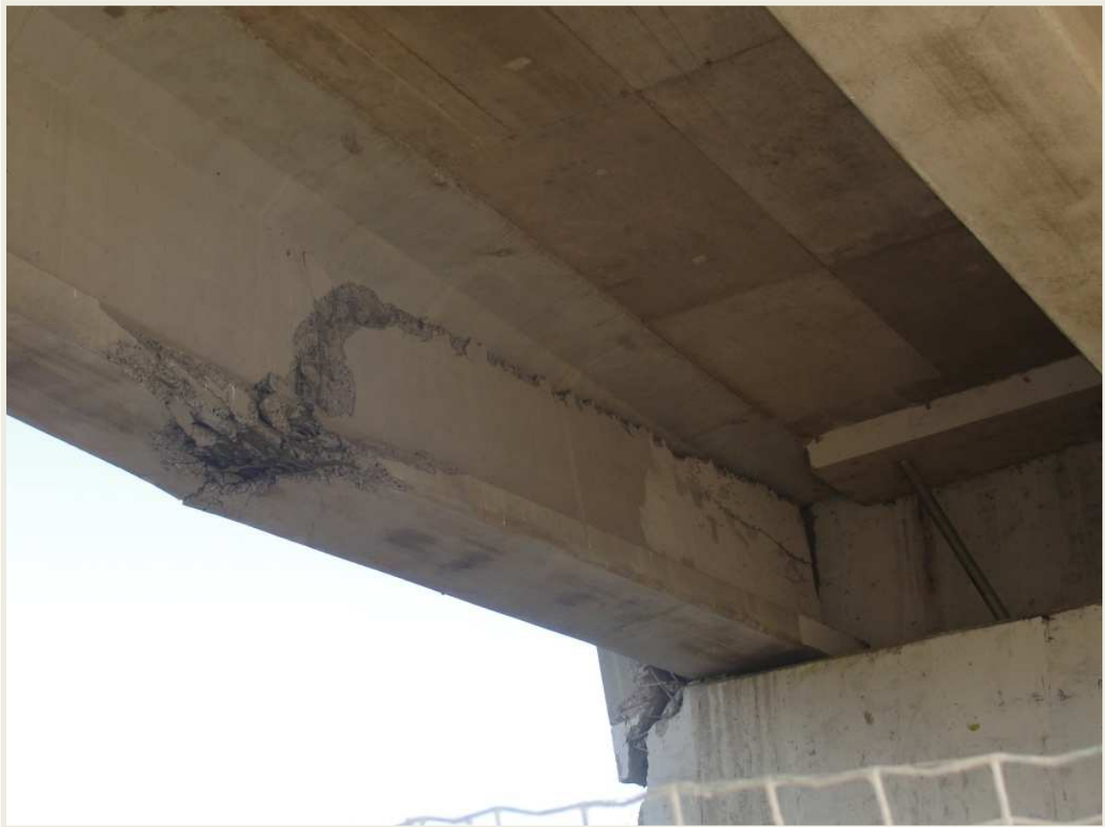
Figura 35: Viga con daño severo en tablero sin travesaño. Fuente: Propia (08/03/2010).
