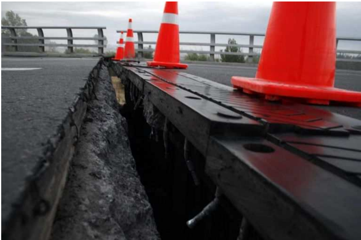
Figura 59: Junta de dilatación con daño tras el terremoto. Fuente: PREANSA (02/06/2010)
