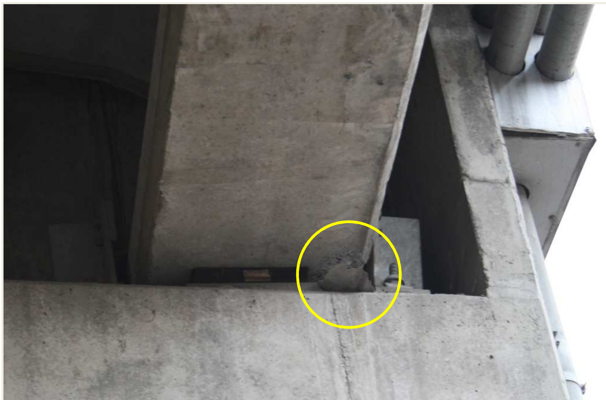
Figura 29: Detalle de viga con daño leve tras el terremoto. Fuente: Propia (26/04/2010).
