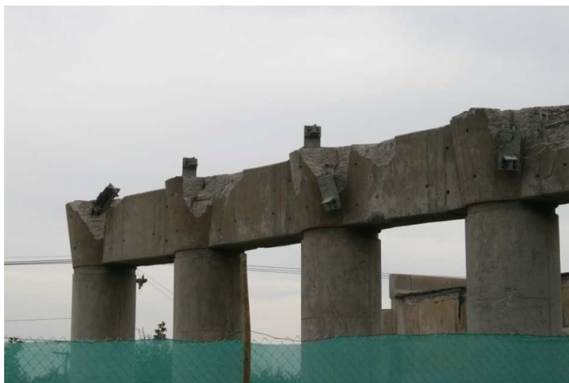
Figura 55: Anclaje vertical en grapa o clip colapsado por la combinación de esfuerzos horizontales y verticales. Fuente: Propia (03/03/2010)
