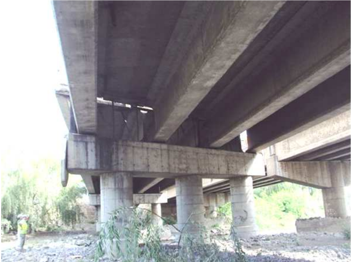
Figura 60: Junta de dilatación con daño tras el terremoto. Fuente: PREANSA (02/06/2010)
