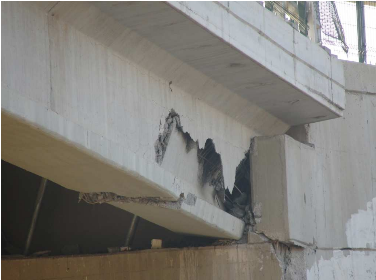
Figura 52: Colapso de viga doble T por fallo de alma y de cabeza inferior. Fuente: Propia (08/03/2010).
