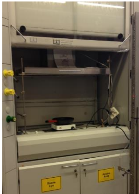
Figura 8.2.1.1. Ubicació de la campana extractora.
