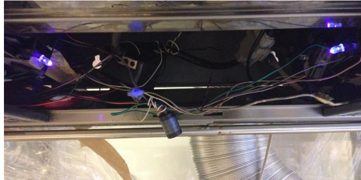
Figura 4.1.1. Imatge dels LEDs de llum ultraviolada.
