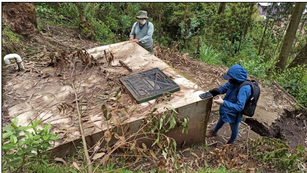
Tanque de regulación del sector
