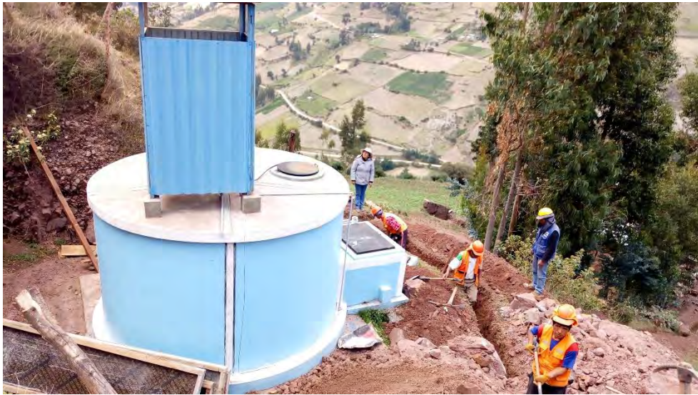
Foto 5.4: Sistema de cloración del agua por goteo
