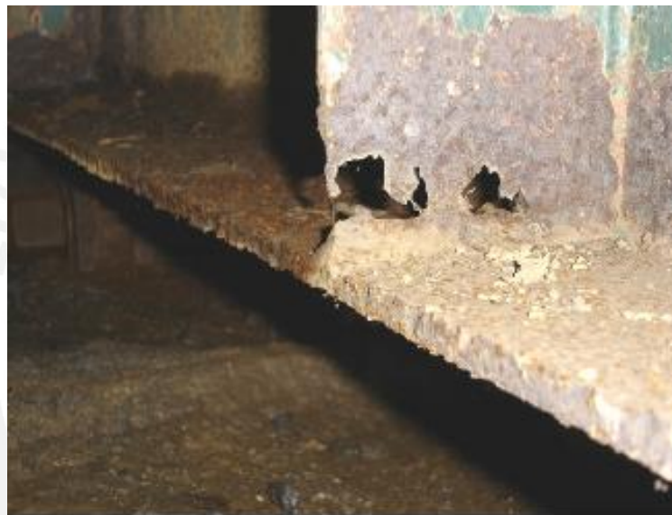
Figura 3. 17: Corrosión del atiesador vertical en viga principal (MOPT, 2007).
