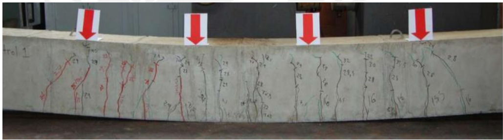
Figura 3. 3: Fisuras por flexión (Cabrera, 2011)
