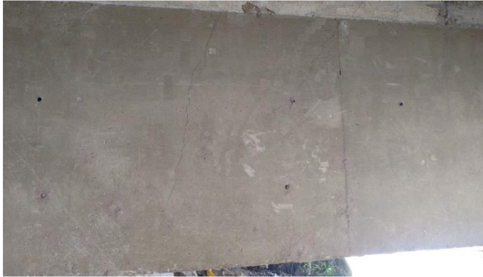
Figura 3. 2: Fisura por cortante en vigas (Meyhuey, 2018).
