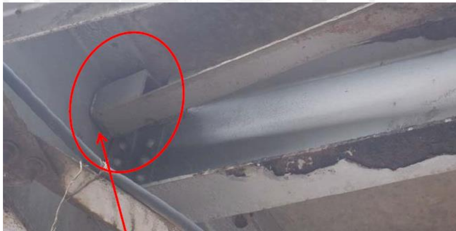
Figura 3. 20. Desprendimiento de soldadura (Liu-Kuan et al., 2015)
