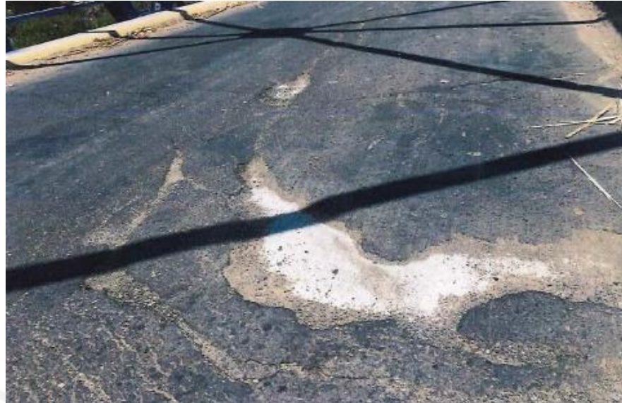
Figura 3. 13: Desgaste en el asfalto y losa por abrasión (Fuente: Elaboración propia).
