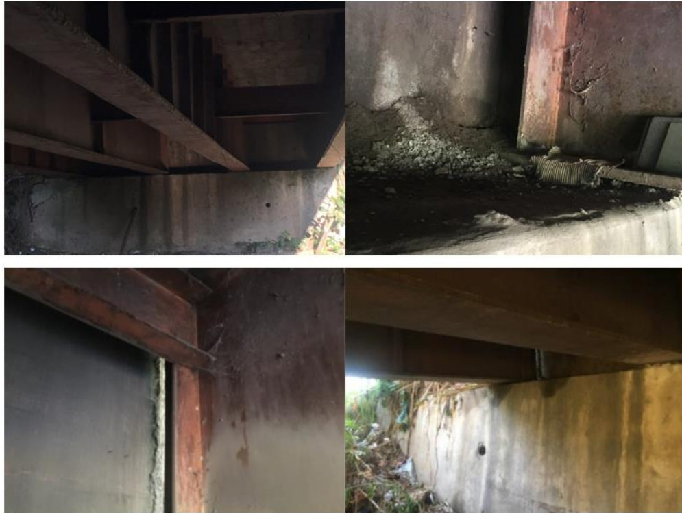
Figura 4. 4: Corrosión en la estructura metálica del Puente Río Shilcayo.
