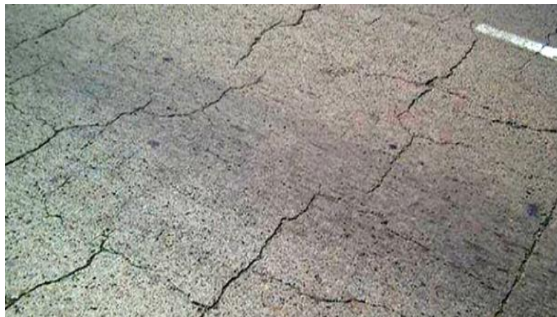
Figura 3. 7: Fisuras por mala calidad del material (Exceso de agua en el costo del hormigón, n.d.)
