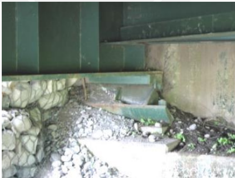
Figura 3. 26: Desplazamiento en apoyo metálico (MOPT, 2007)
