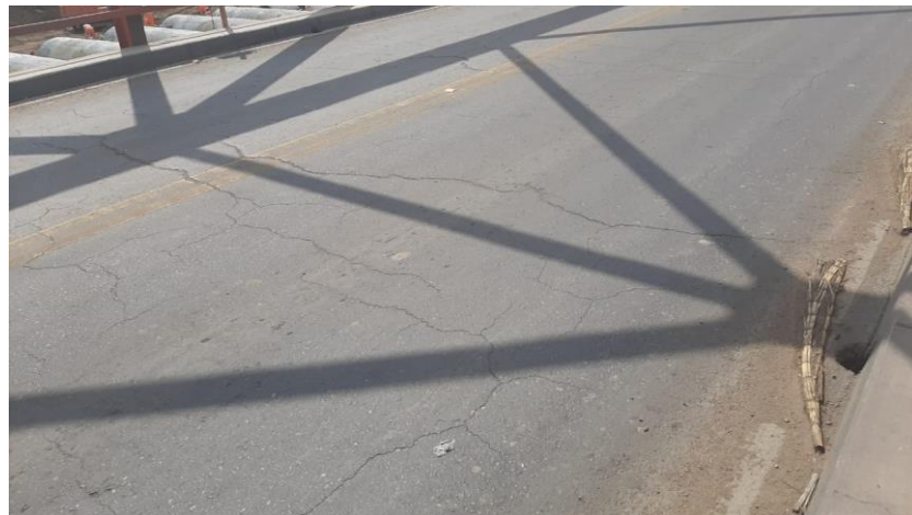
Figura 3. 4: Grietas en el pavimento (Fuente: Elaboración propia).
