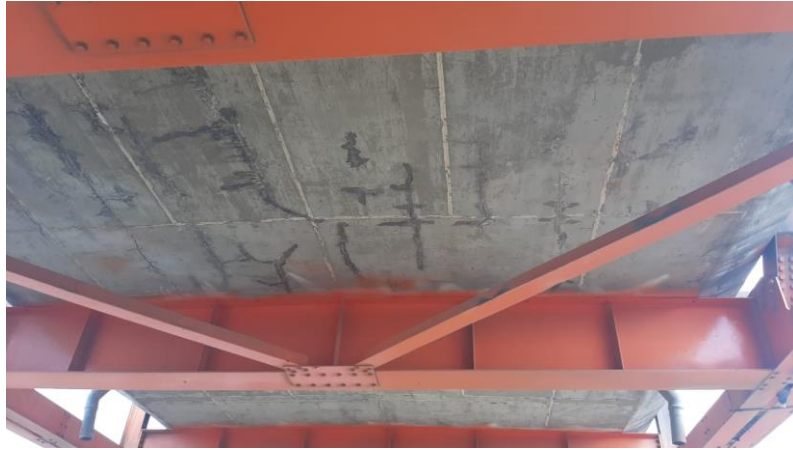
Figura 3. 5: Fisura en losa en una sola dirección (Fuente: Elaboración propia).
