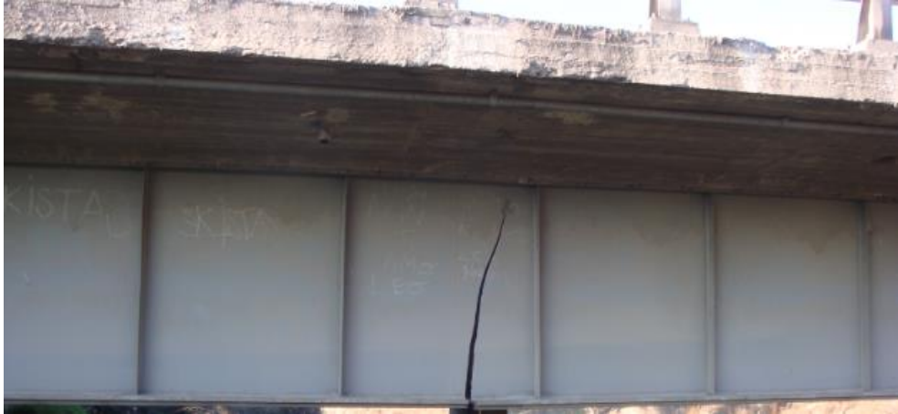
Figura 3. 23: Fisura en viga principal de puente de sección compuesta (REPARACIÓN VIGA DE ACERO DAÑADA POR FATIGA PUENTE PUDAHUEL NORTE, RUTA 68 – JLS Ingeniería, n.d.)
