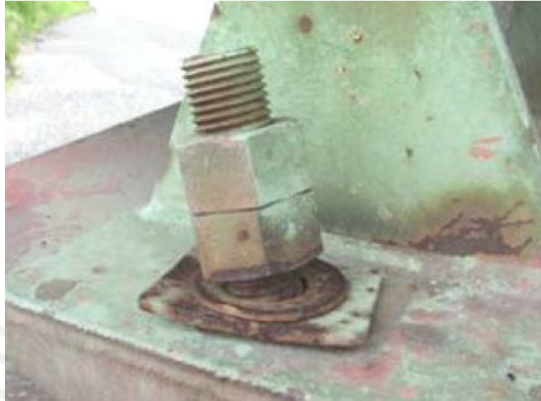
Figura 3. 25: Rotura de pernos de anclajes en apoyos (MOPT, 2007)
