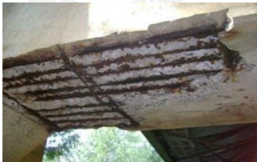
Figura 3. 14: Corrosión en el acero de refuerzo de vigas (Monjo Carrió, 1994).
