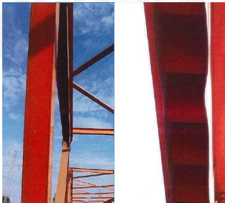
Figura 3. 22: Pandeo local de brida (Fuente: Elaboración propia).
