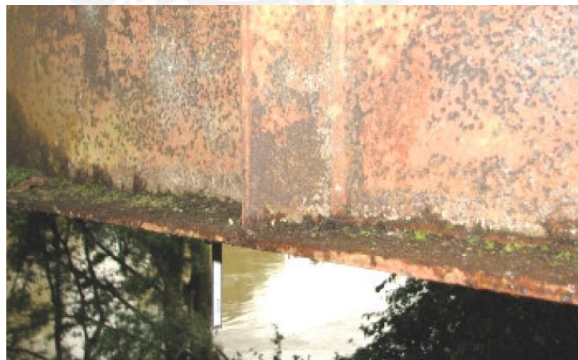
Figura 3. 18: Oxidación de viga principal (MOPT, 2007).
