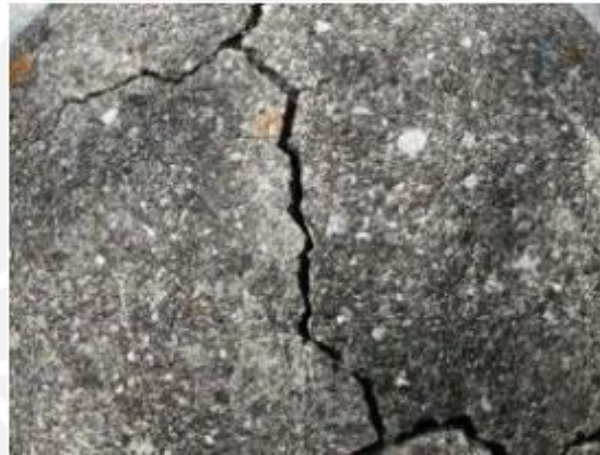
Figura 3. 11: Grietas por hielo y deshielo (Los ciclos hielo-deshielo en el hormigón | MÁS QUE INGENIERÍA, n.d.)
