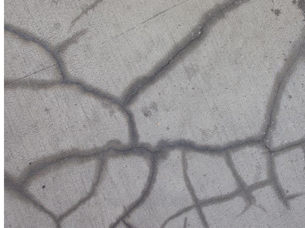
Figura 3. 10: Fisura por retracción del concreto (Retracción: Fisuras en el concreto | ARGOS 360, n.d.)
