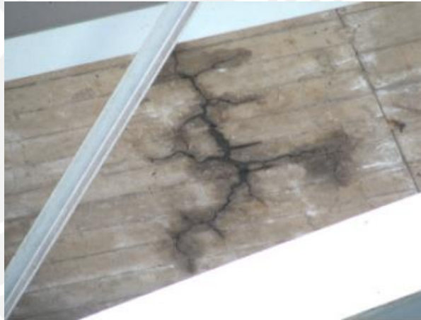
Figura 3. 6: Fisura en losa en dos direcciones (MOPT, 2007)
