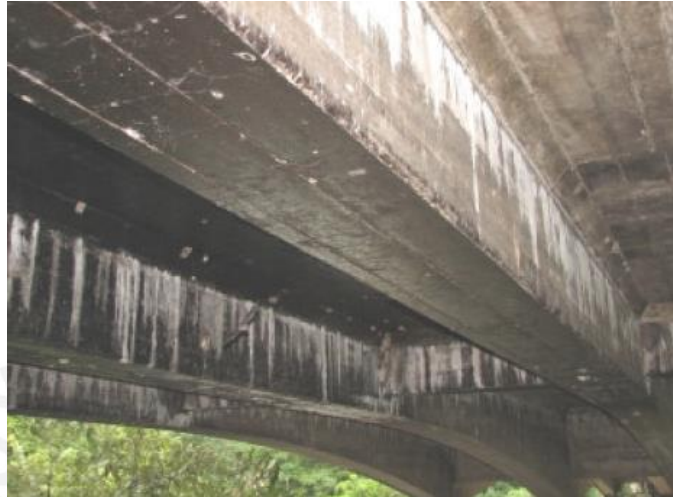
Figura 3. 15: Eflorescencia en la viga principal (MOPT, 2007)
