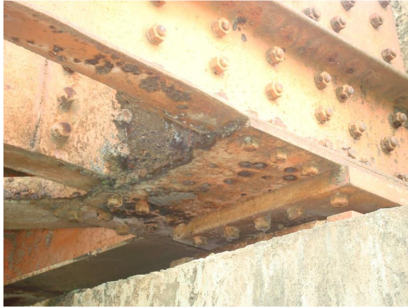
Figura 3. 19. Corrosión en conexiones (Fuente: Elaboración propia).
