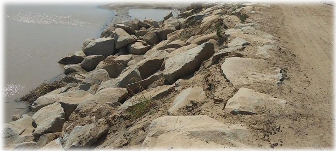
Anexo 3.12: Zonas dañadas por aumento del cauce.
