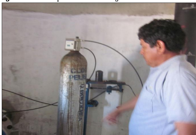
Imagen N° 15: Operador encargado de la Clorificación.
