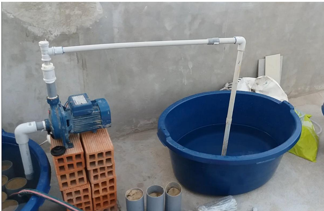
FOTOGRAFÍA 1.22: SISTEMA DE BOMBEO
