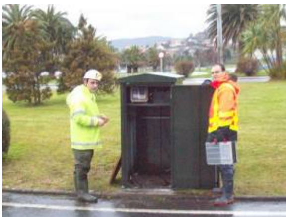
Figura 6.- Situación de la estación de control, en el borde de una glorieta.
