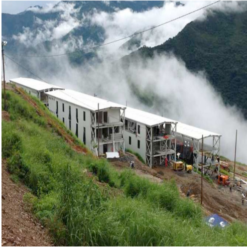
(a) Villa luz hidroeléctrica-Hidroituango.
