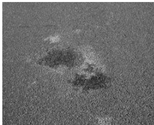
Figura 2.25 – Infiltração de água no pavimento (Blazejowski, 2011)
