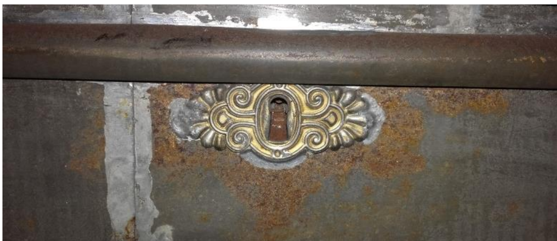
Fig. 9 – Pormenor da fechadura de uma das caixas metálicas.
