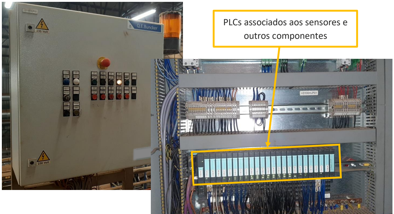
Figura 50 - Quadro elétrico associado ao equipamento Bunker (Secção I) e respetiva estação de controlo remoto
