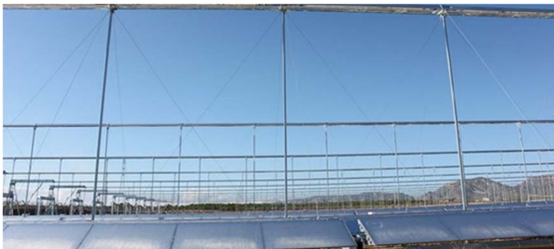
Εικόνα Α.20: Οι απορροφητές του ηλιακού θερμικού σταθμού Puerto Errado
