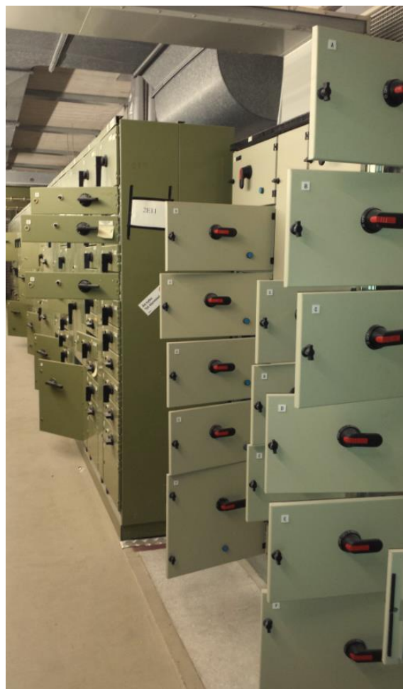
KUVA 10. Varaosakartoituksen aikana avattu moottorilähtökeskusten kennoja.
