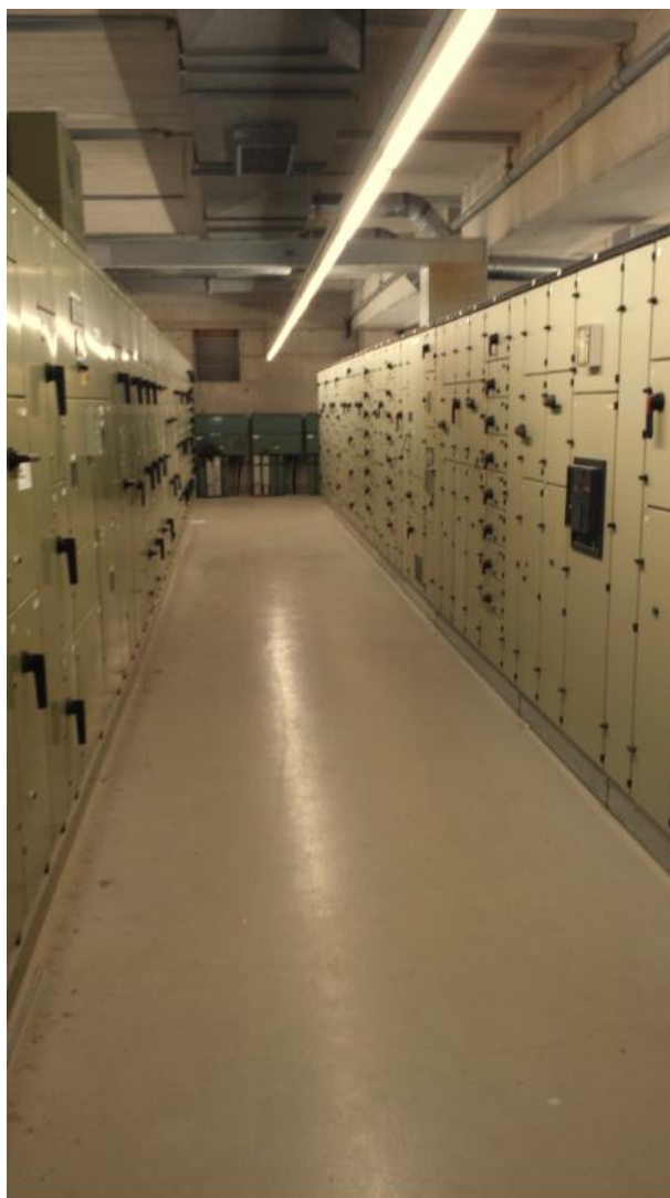
KUVA 4. Tehtaan erään sähkötilan kennokeskukset.
