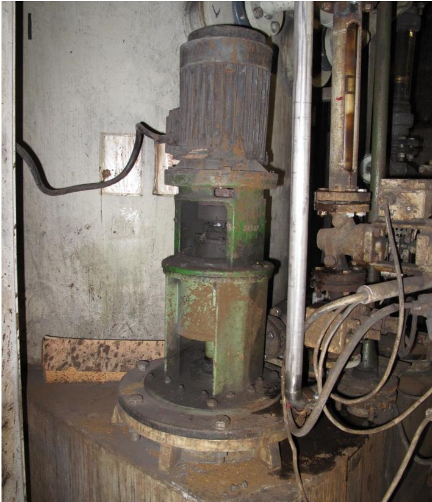
KUVA 18. HP3:n elektrolyyttipeittauksen kaasunpesun kierrätyspumppu
