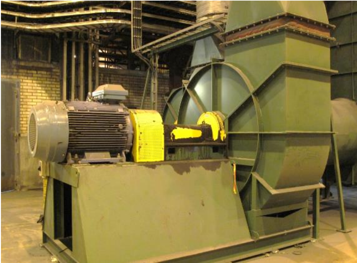
KUVA 4. Keskipakoispuhallin HP1:n jäädytyksen pölynpoistossa
