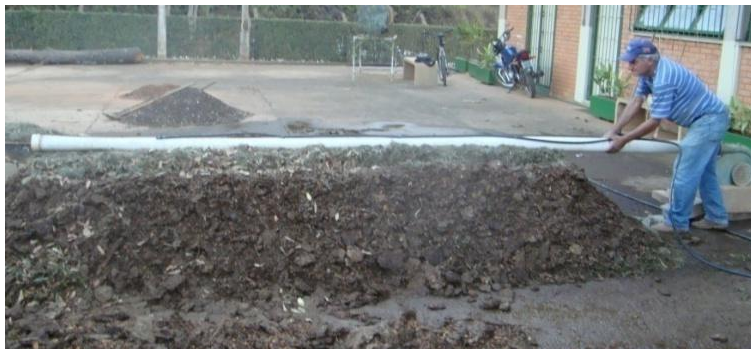
Figura 4 - Mangueira com aspersores acoplada à tubulação
