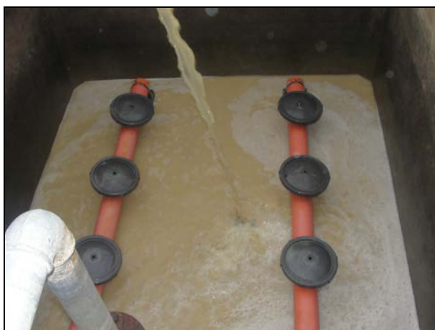
Figura 1 – Tanques de aeração com efluente.
