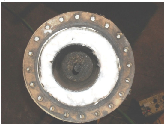
Figura 4. Isolamento térmico com lã de vidro Figure 4. Thermal insulation de glass wool
