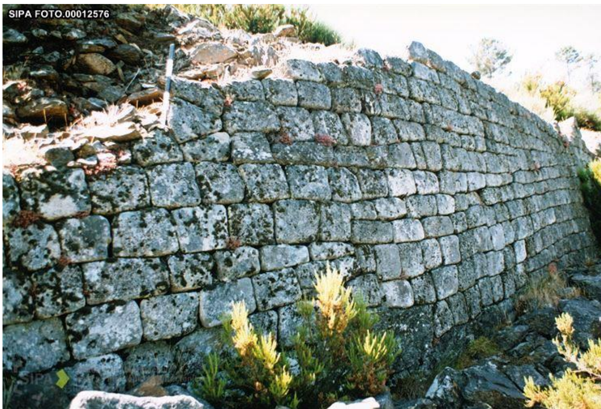
Figura 138: Pormenor do aparelho poligonal da muralha do Castelo dos Mouros de Jales (© Sistema de Informação para o Património Arquitectónico - SIPA, Instituto da Habitação e da Reabilitação Urbana, I.P. - IHRU).
