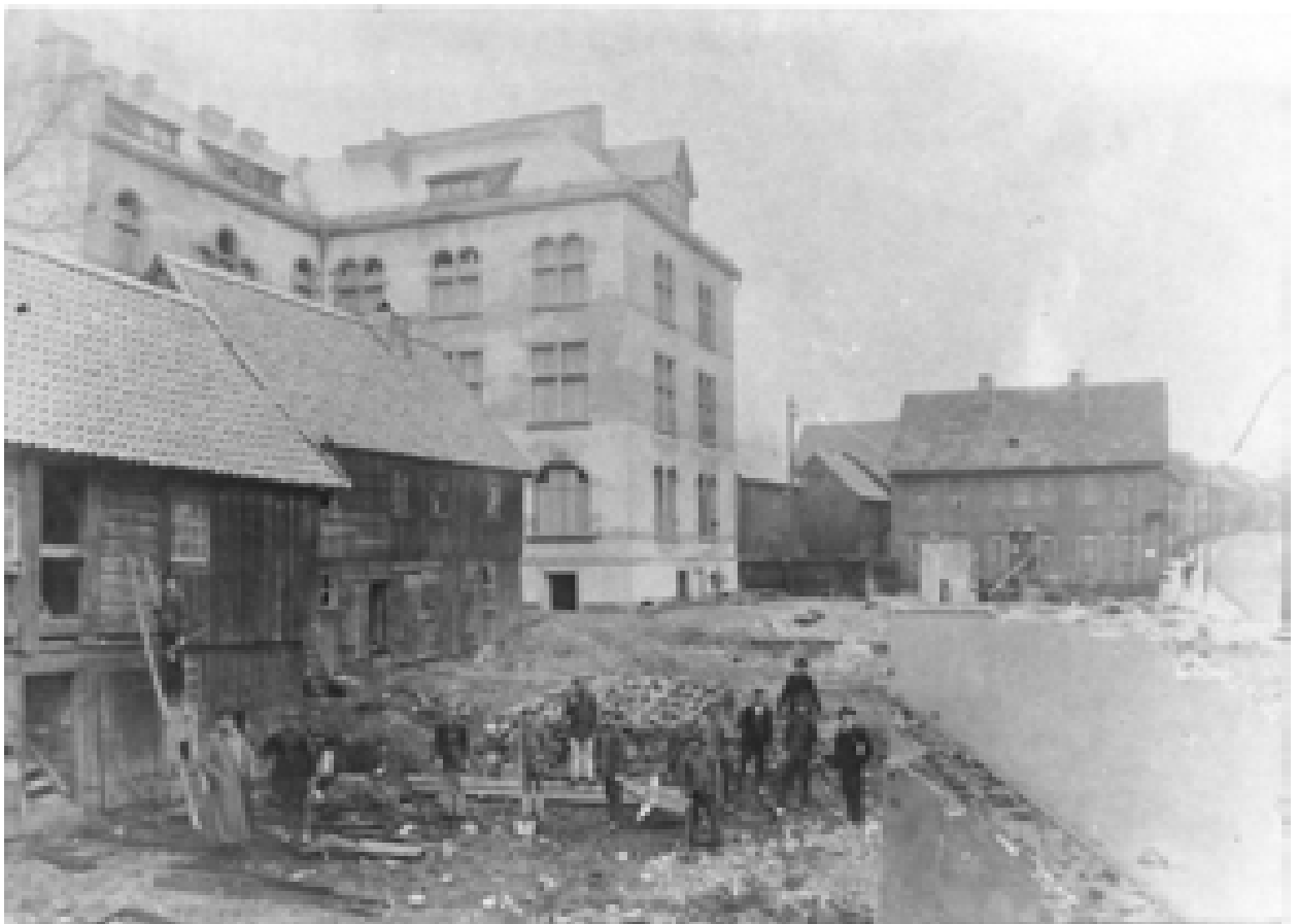
Abb. 061a: Rechts steht noch der östliche Giebel des alten Bergakademiegebäudes. Der Blick über die Baustelle reicht bis hin zu Marktkirche, Oberbergamt und Geschäftshaus in der Goslarschen Straße. (Glasplatte 3-I, Archiv TU)
