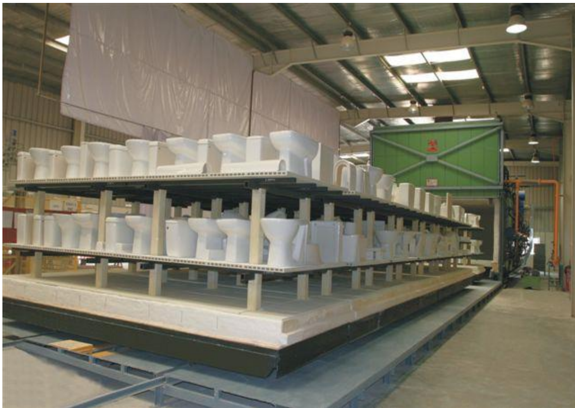
Abb. 5.2.1.10: Ofenanlage für Sanitärkeramik – Herdwagenofen (kurze Brennzeiten durch Vollfaserauskleidung).
